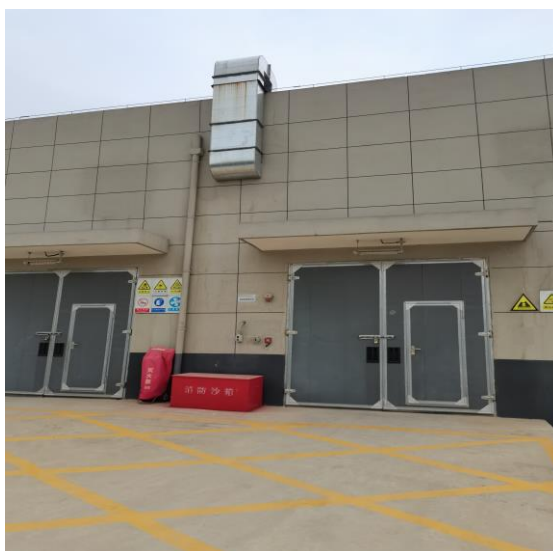
危废间排气筒
