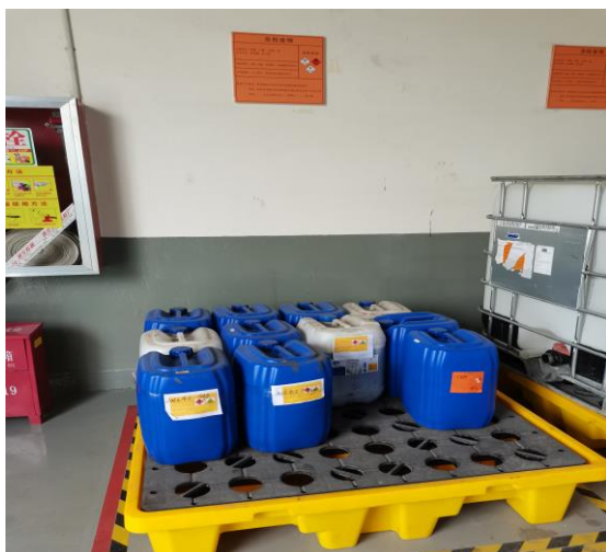
危废间托盘及防渗地面
